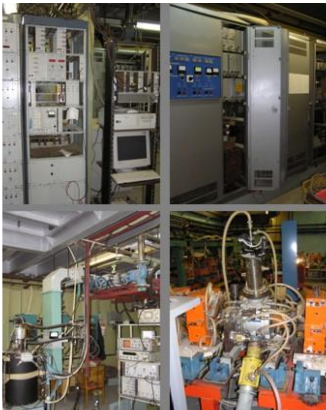
Рис. 2. Элементы ВЧ системы накопителя-охладителя: (слева-направо, сверху-вниз) стойка управления ВЧ станции, высоковольтное питание клистрона, клистрон 700 МГц и волноводная система, резонатор накопителя-охладителя
